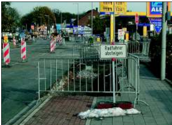
Warum „Radfahrer absteigen“? Auf der Fahrbahn ist ausreichend Fläche verfügbar. Und: Die Baugrube ist nicht ausreichend gesichert.
