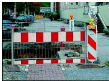
... mit geringem Aufwand sicherer gestalten: Absperrschranke, Bake und Beleuchtung.
