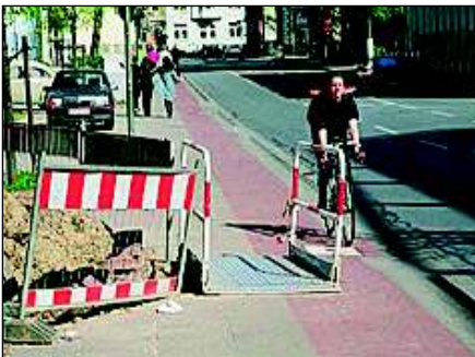
Das Gelände auf dem Brückenelement reduziert die verbleibende Breite. Besser wäre der Einsatz einer Abdeckplatte, die vom Radverkehr überfahrbar ist.
